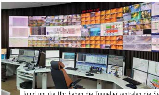
Rund um die Uhr haben die Tunnelleitzentralen die Sicherheit der Anlagen im Blick. (Foto: DJD/Scholz & Friends)
